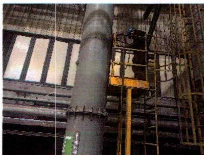
图 2 中频炉排放口
