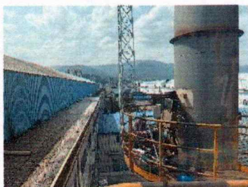
图 19 熔铸 5、6 炉内废气排气筒
