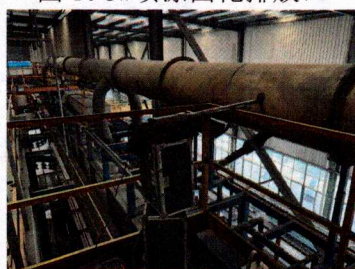
图 13 3#喷涂酸雾排放口
