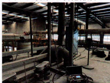
图 10 3#喷涂固化排放口
