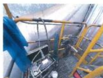
图3 35t 熔铝炉炉内废气+35t 保温炉炉内废气进口
