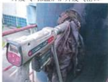
图5 回转窑+冷灰桶排气筒出口
