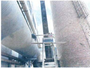
图 7 22t 熔炼炉、熔保炉排气筒
