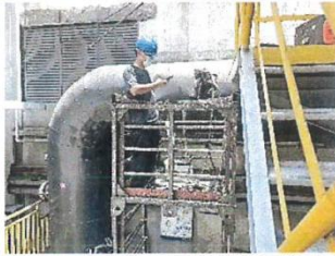
图 8 25t 熔炼炉、熔保炉排气筒进口
