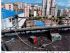
图 22 洗模中心 2#碱雾排气筒
